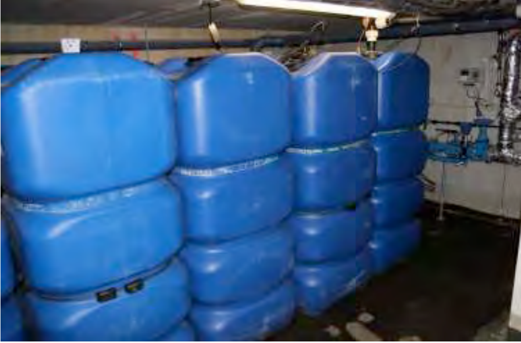
Şekil 3: Yağmur Suyu Depolama Tankları
